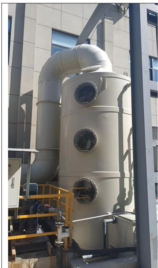
废气处理设施
